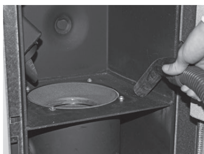
rys. 72 Usunąć resztki popiołu i zanieczyszczeń
